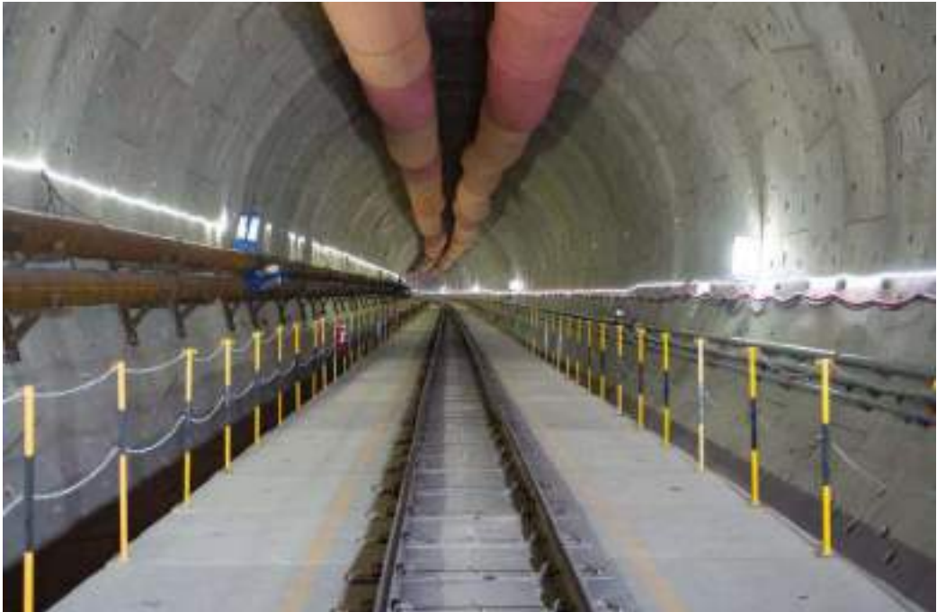
Gambar 1. 3 Bagian dalam terowongan nomor-1 sepanjang 1.885 meter pada proyek kereta cepat Jakarta-Bandung yang digali dengan tunnel boring machine berdiameter 13,23 meter (Sumber: Xinhua/Du Yu)
