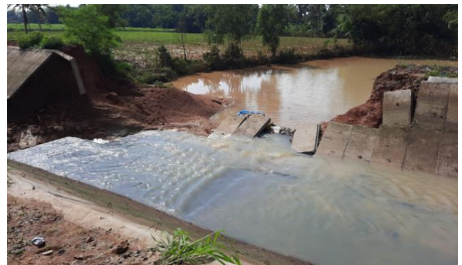
Gambar 4.2. Kerusakan Tanggul Saluran Primer Raman Utara
