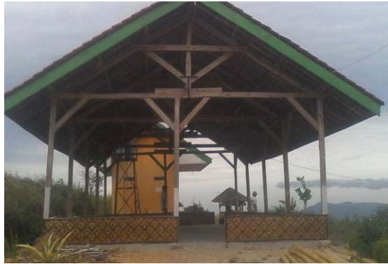
Foto 7.3 Pembangunan pondok pertemuan di lokasi pengembangan ekowisata berbasis masyarakat di Gunung Betung (Foto oleh Christine Wulandari, 2016)
