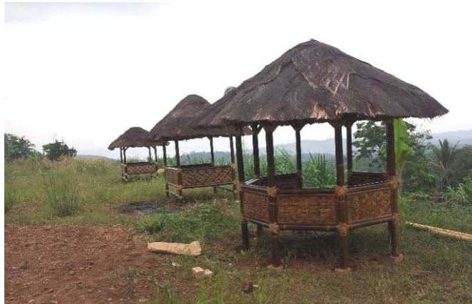
Foto 7.2 Pembangunan 3 buah gazebo di lokasi pengembangan ekowisata berbasis masyarakat di Gunung Betung (Foto oleh Christine Wulandari, 2016)
