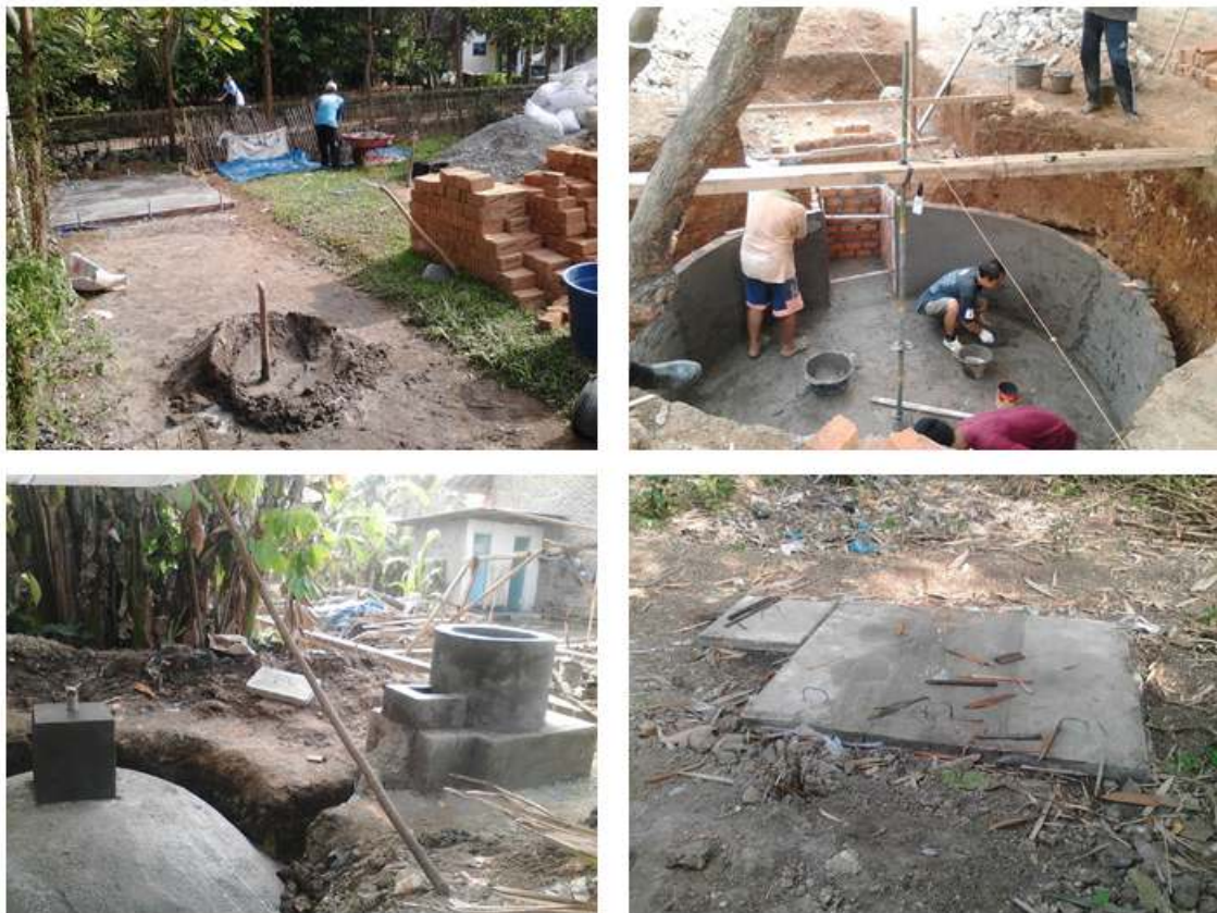
Gambar 2. Instalasi digester tipe fix dome di rumah warga Dusun Kediri II
