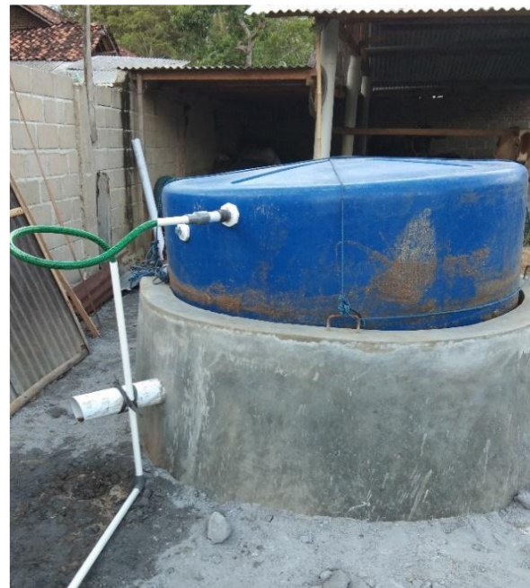
Gambar 2. Digester biogas tipe floating tank dalam keadaan sudah terinstal
