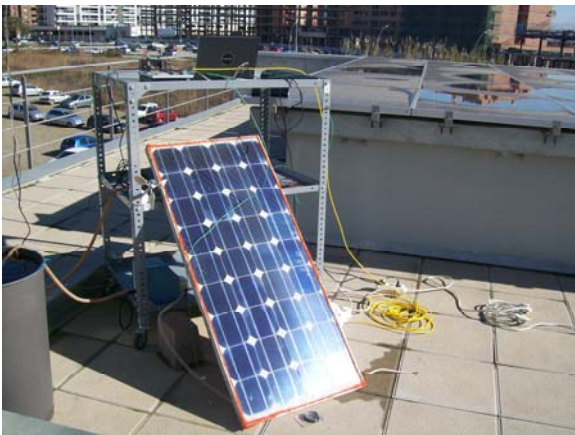
Gambar 1. Instalasi alat uji
