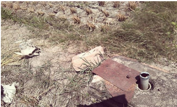
Gambar 3. Sumur bor dangkal yang sudah tidak ekonomis dari sisi operasional.
