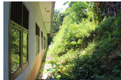
Gambar 6. Foto darat terkait kondisi bangunan sekolah yang sering mengalami runtuh tanah saat hujan.
