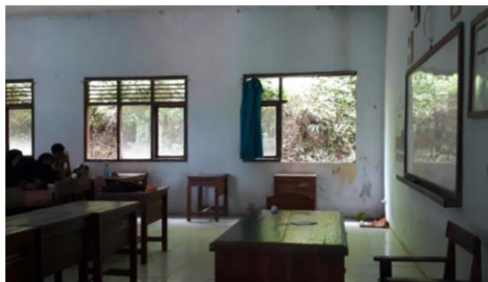
Gambar 4. Runtuhan tanah di belakang bangunan sekolah.
