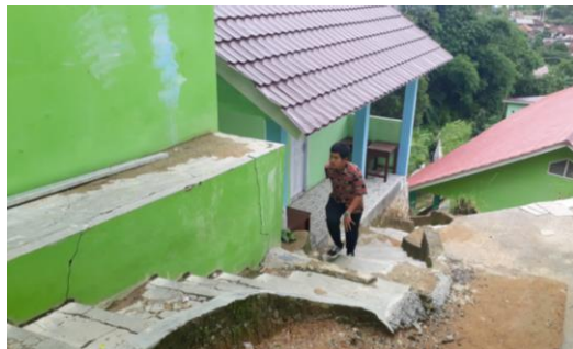
Gambar 3. Retakan di beberapa bangunan sekolah.
