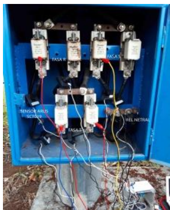
Gbr.2 Set-up Rangkaian Pengujian.
