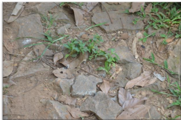
Gambar 3. Pemasangan batu belah yang tidak tegak
