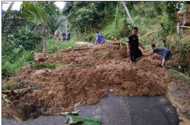
Batu dan tanah longsor menutup Jalan Suban, Panjang, Bandar Lampung, Kamis (30/4/2020)
