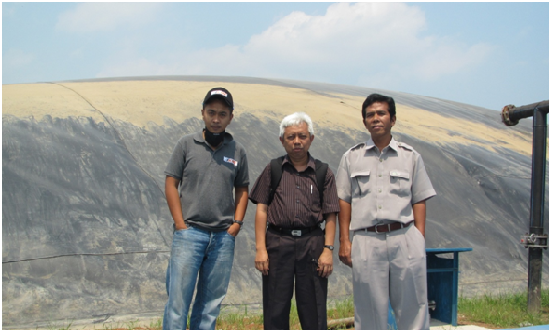
Gambar 9. Digester biogas tipe covered lagoon berukuran 50 m x 110 m dengan kedalaman 6,5 m di PKS Tandun, PTPN V Riau, menjadi sumber bahan bakar PLT Biogas dengan kapasitas 1 MW.
