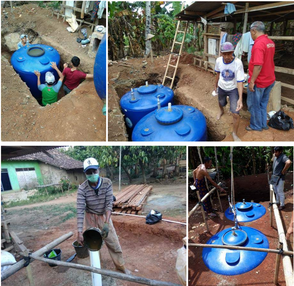
Gambar 13. Instalasi biogas rumah tangga 2 x 2 m 3 untuk pengujian genset
