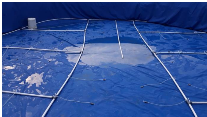
Gambar 5. Instalasi aerasi dengan pipa dan slang di dasar kolam.
