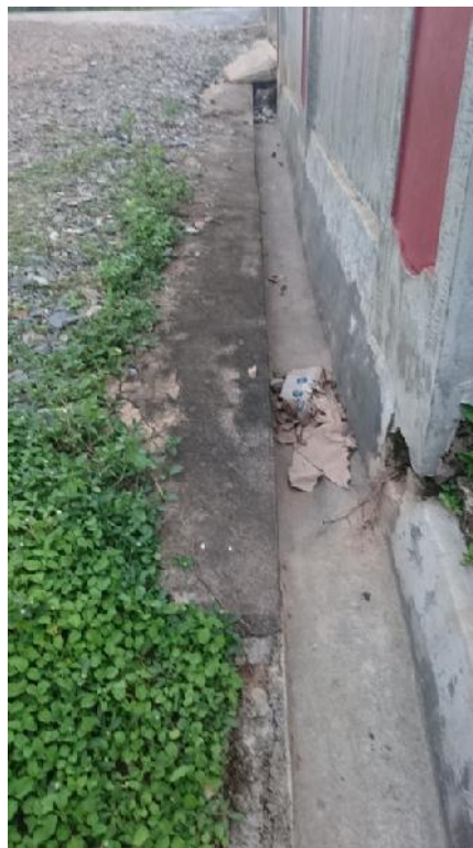
Gambar 6. Saluran di depan rumah warga yang lain, yang sudah dibeton
