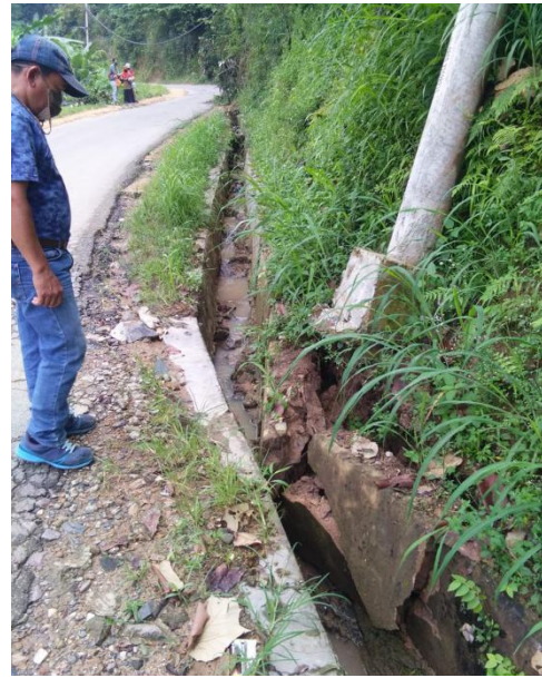
Gambar 5. Kondisi infrastruktur yang rusak akibat adanya pergerakan massa longsor/tebing.
