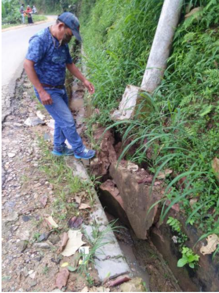
Gambar 1. Kondisi tiang listrik di Jalan Raya Suban, Pidada, terangkat diakibatkan adanya pergerakan tanah
