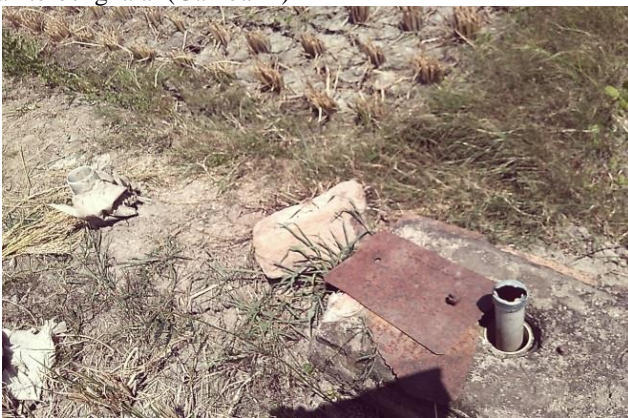
Gambar 2. Sumur bor dangkal yang sudah tidak ekonomis dari sisi operasional.
