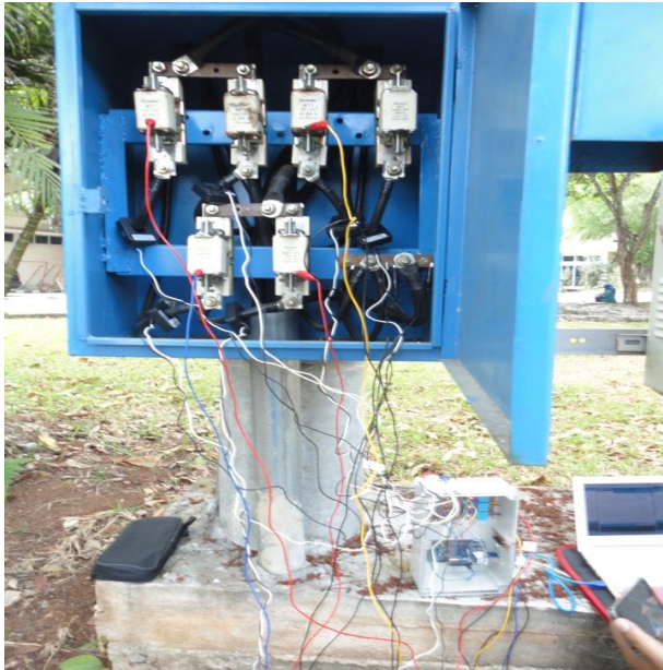
Gambar 3. Rangkaian Pengujian Pada Transformator Distribusi
