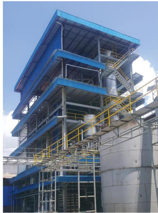
Gambar 2. Salah Satu Stasiun Produksi Pabrik Biodiesel PT. TBLA
