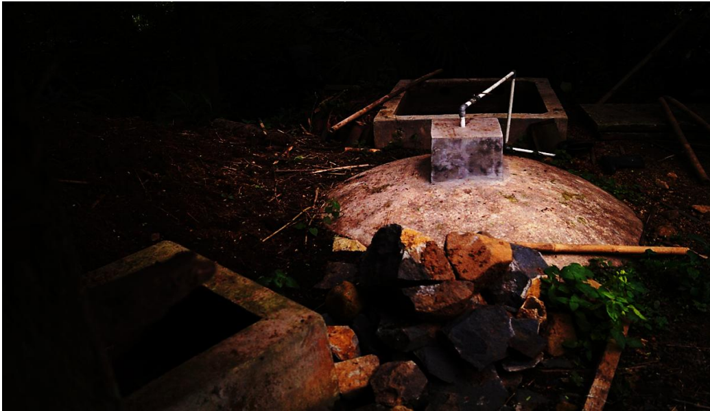
Gambar 3. Bangunan inlet kubah dan outlet tidak satu garis lurus.
