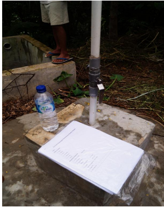
Gambar 5. Pipa penyalur gas utama sangat jauh dari standar
