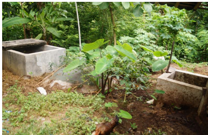
Gambar 1. Bangunan outlet (kanan) lebih tinggi daripada bangunan inlet (kiri) dan kubah tidak sesuai standart.
