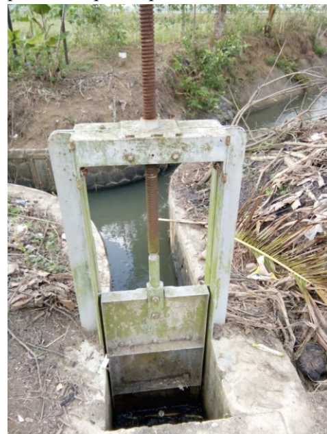
Gambar 2. Kondisi pintu air irigasi yang bocor
