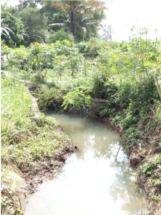
Gambar 3. Lining saluran tidak terawat
